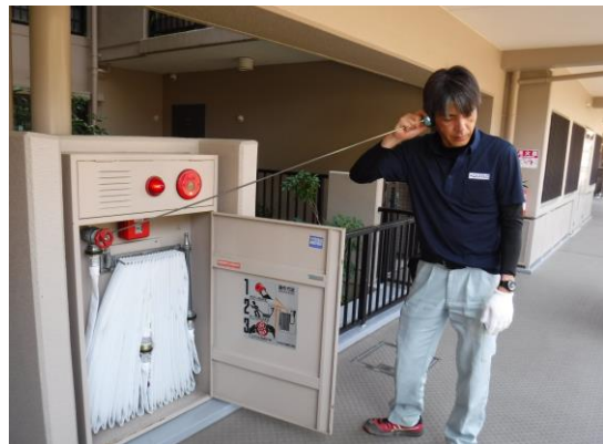
音聴棒にて消火栓の音聴
