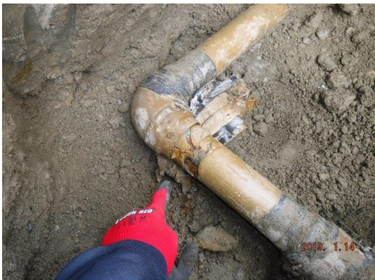
漏水箇所を確認 調査で指示したポイントにずれなし
