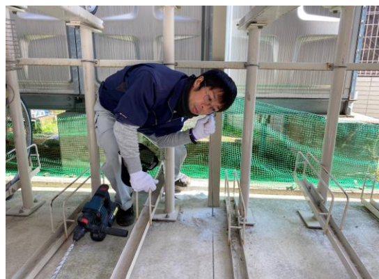
地中音聴で漏水による噴射音を確認 漏水箇所を確定し調査を終了
