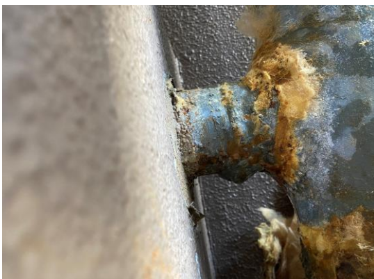
溶接部にて漏水を確認
