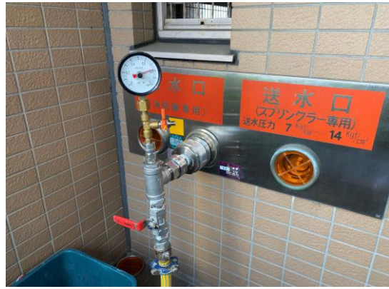
送水口接続部
