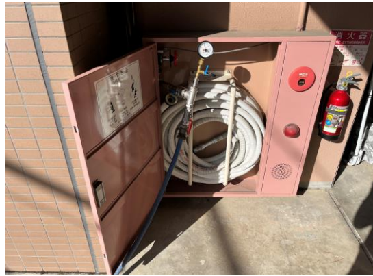
消火栓接続状況
