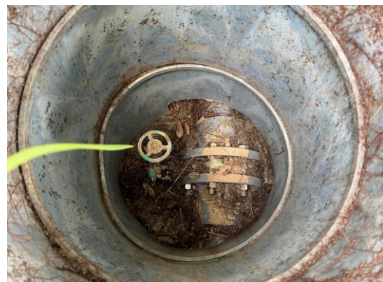
漏水箇所を特定
