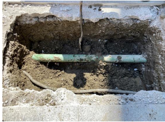
既設管漏水状況
