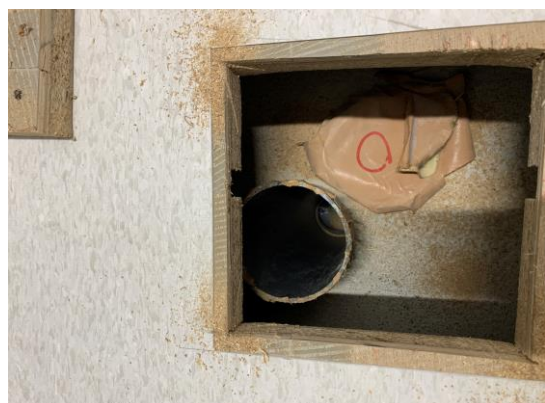
排水管破損箇所を無事発見し調査終了
