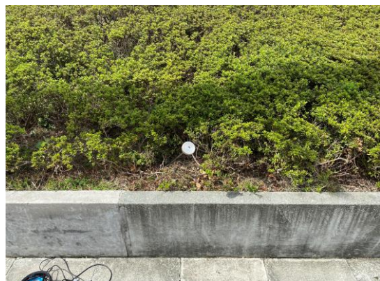
植栽下埋設管で噴射音を確認し漏水箇所に確定
