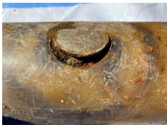
漏水箇所拡大 キーロン管被覆部破損により内部腐食
