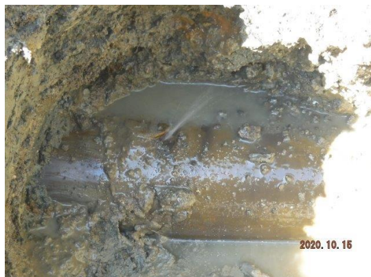
漏水箇所を確認
