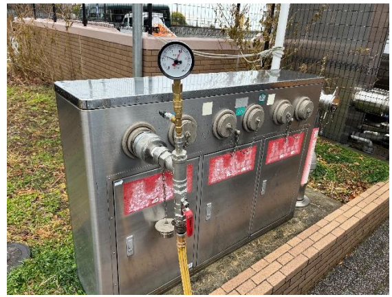
送水口接続状況
