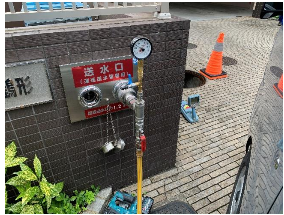
送水口接続状況
